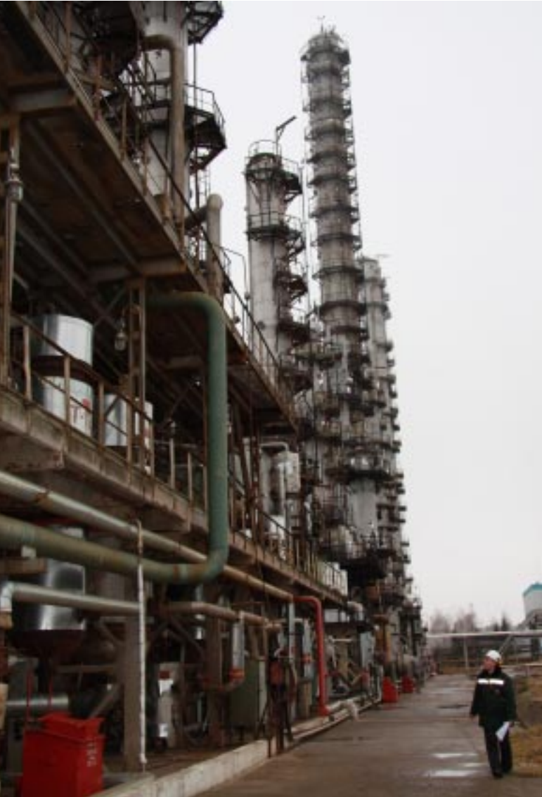
На ректификационных колоннах этилен отделяют от этана, а пропилен от пропана
